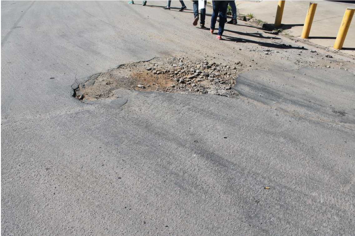
Figura 9: Foto in loco , buracos em ruas de grande circulação.
